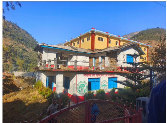
भुकम्पबाट क्षतिग्रस्त जाजरकोट जिल्ला अन्तरगत नलगाड सब डिभिजन वन कार्यालय भवन
